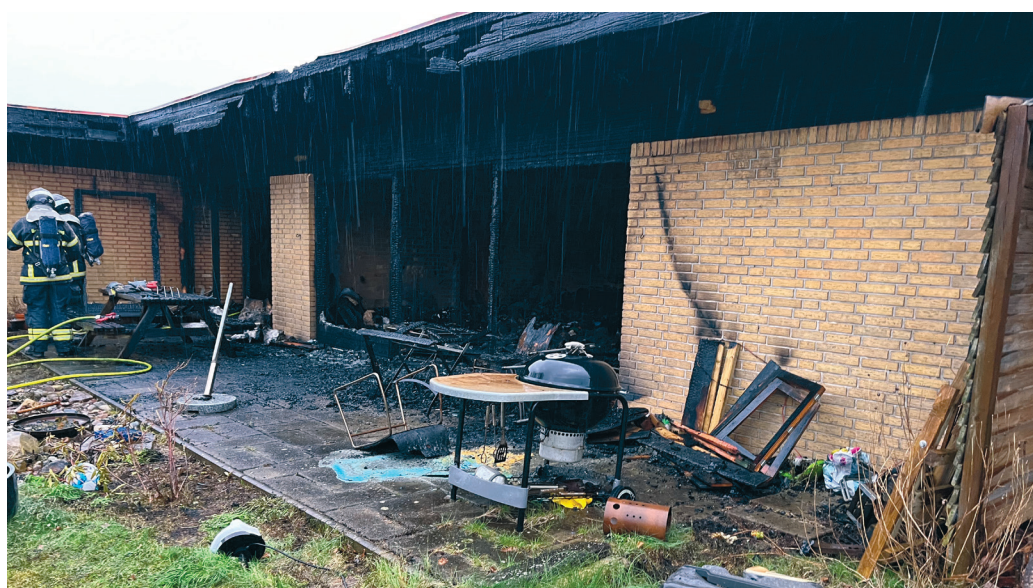
Die ausgebrannte Ruine am Mølløvænget in Hostrupholz
