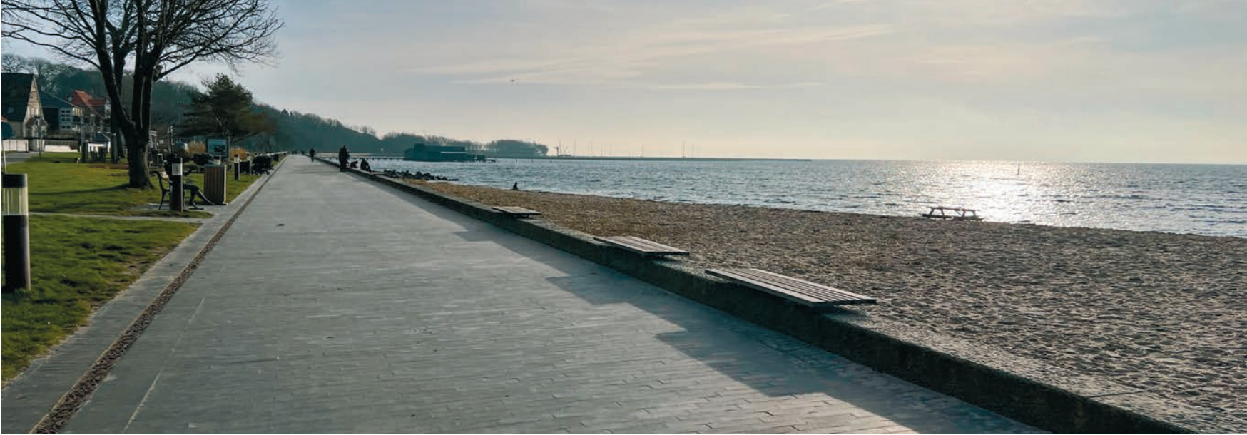
Die 215.640 Steinfliesen waren 2017 eigens für die Sonderburger Promenade hergestellt worden. Schnell zeigte sich, dass die Steine nicht fest genug im Boden verankert waren und den Wetterverhältnissen nicht standhalten konnten. SARA ESKILDSEN
