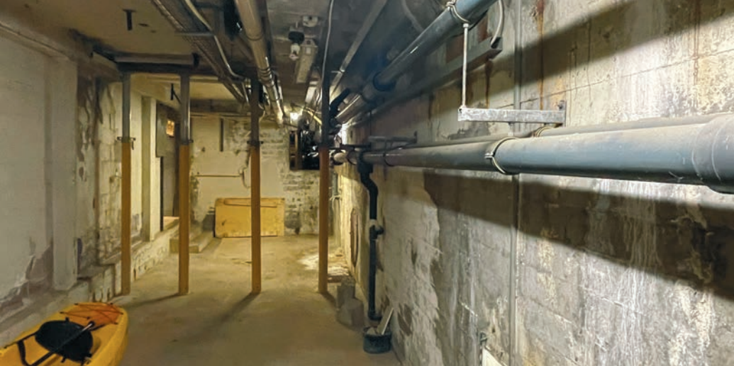
Der „alte“ Kellerbereich unter dem Schwimmbecken stammt aus dem Jahr 1970. Hier waren auch Chlor und Salzsäure untergebracht.
