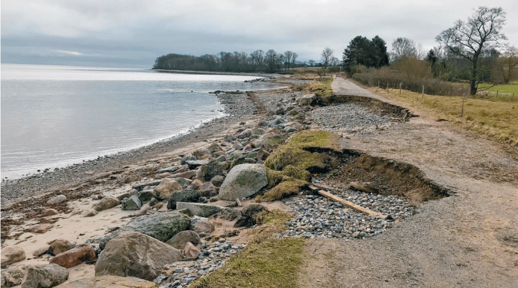
Bei Skeldebro wurde an vielen Stellen der Gendarmenpfad beschädigt. SØNDERBORG KOMMUNE
