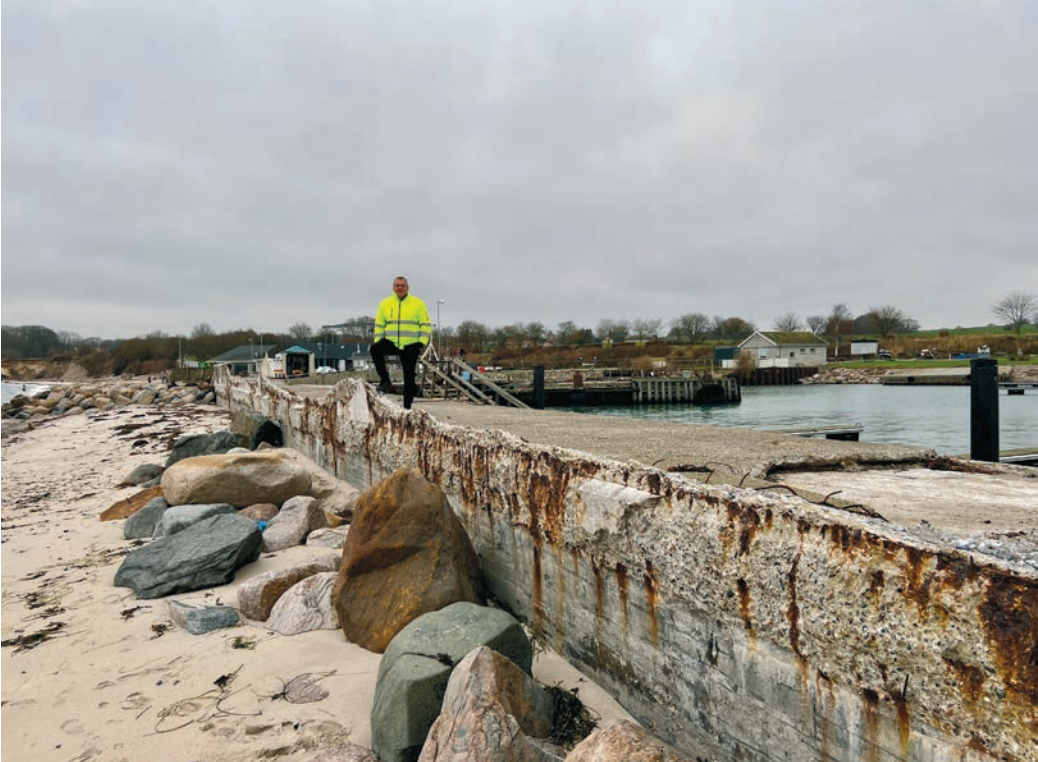
Carsten Kock auf der zerstörten Außenmole. Vor der Sturmflut stand hier eine Mauer.
