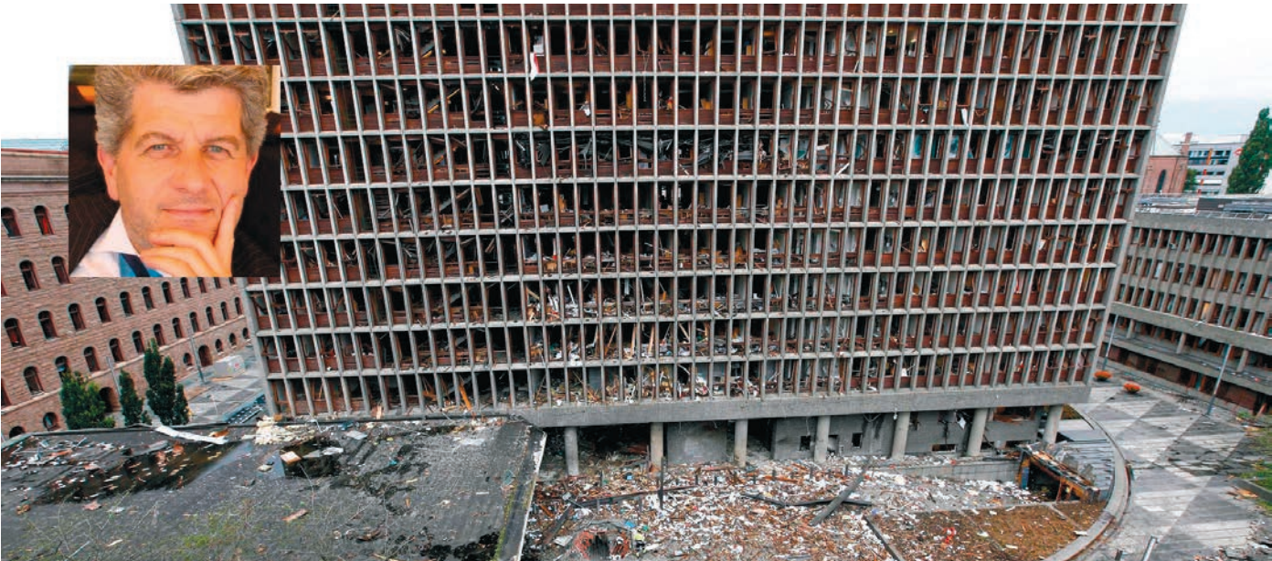
Das Regierungsgebäude in Oslo nach dem Bombenanschlag. Kim Jessen wohnt nicht weit davon entfernt.
