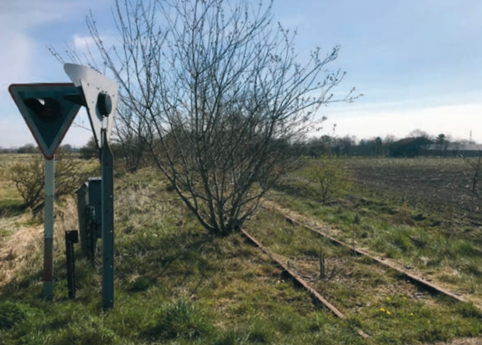
Die Gleise sind verwildert, der Bahnbetrieb ruht seit 22 Jahren. FOTO: MONIKA THOMSEN
