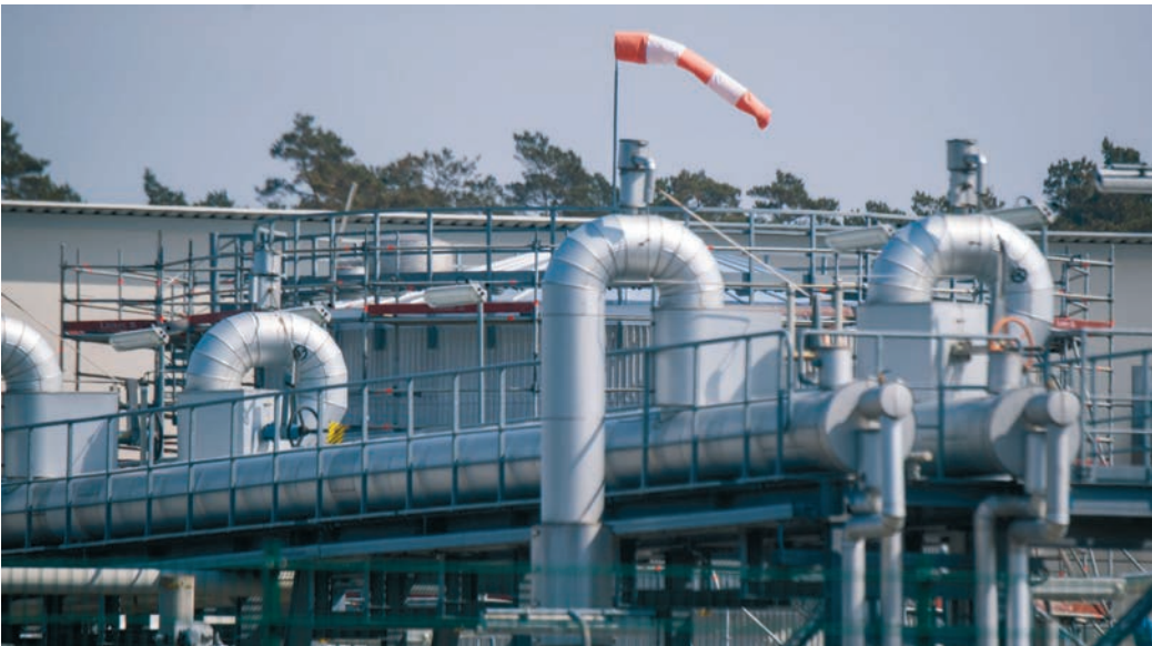
Blick auf Rohrsysteme und Absperrvorrichtungen in der Gasempfangsstation der Ostseepipeline Nord Stream 1 und der Übernahmestation der Ferngasleitung OPAL (Ostsee-Pipeline-Anbindungsleitung) in Lubmin.
