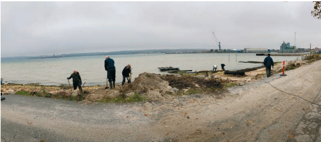
Rund um den zerstörten Anleger hatte die Sturmflut Strandsand auf das Gelände verfrachtet. Die Mitglieder des ARV packten alle mit an, den Sand wieder auf den Strand zu schippen. PRIVAT
