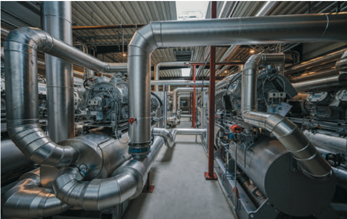
Der Danfoss-Konzern liefert jede Menge Technik zum Klimaschutz. Dazu zählen auch Großwärmepumpen. Zwei werden im Sonderburger Krankenhaus installiert. DANFOSS
