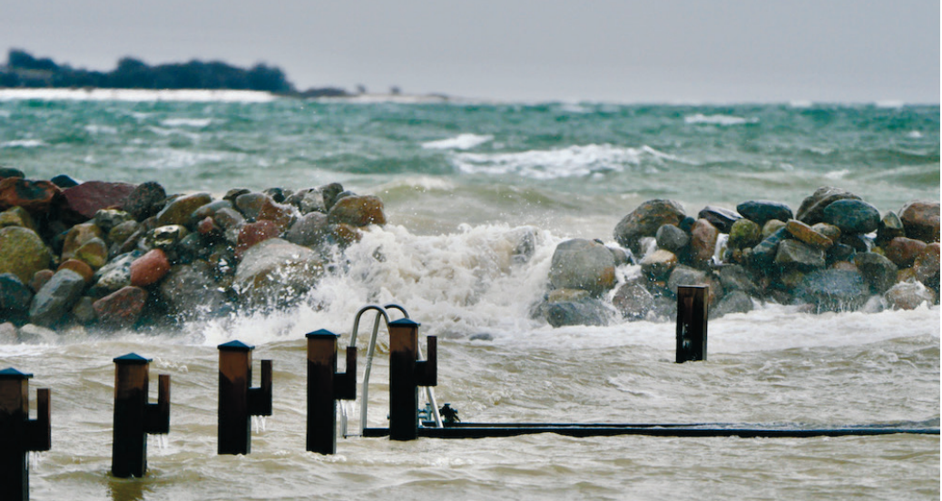
Das Wasser hat ein heftiges Loch in die Ostmole des Jollenhafens gerissen. FOTO: PAUL SEHSTEDT
