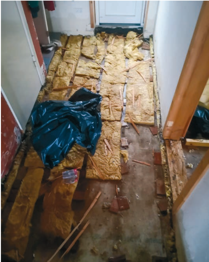
Die Familie entfernte die vollgesogene Isolierung in tagelangem Einsatz, um Folgeschäden zu vermeiden.
