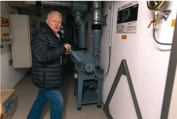
Der ehemalige Hausmeister der Akademie Sankelmark, Peter Weber, demonstriert, wie die Belüftung bei Stromausfall gesichert gewesen wäre – per Handbetrieb.
