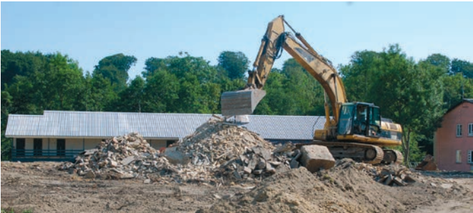
Vom einstigen Hotel ist nur noch Schutt übrig.
