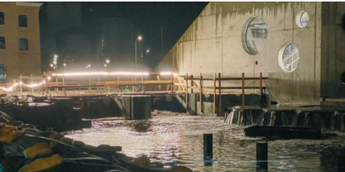
Das Schöpf- und Sperrwerk an der Kreuzung Mølle-mærsk und Kystvej.
