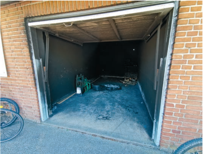
Die Wände sind verrußt und müssen gereinigt werden.
