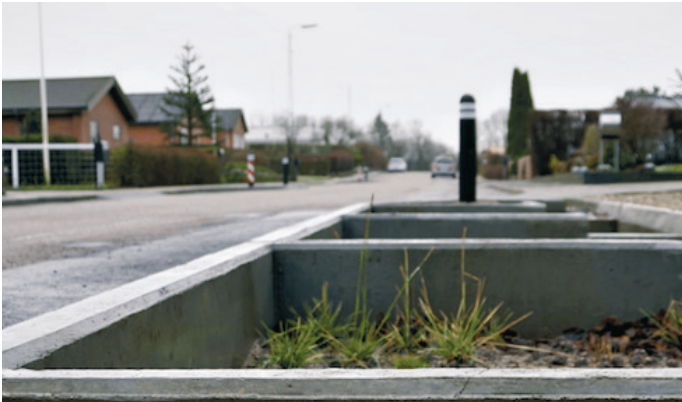
Einige der Mini-Regenwasser-Auffangbecken in Klipleff funktionieren noch nicht ganz nach Wunsch.
