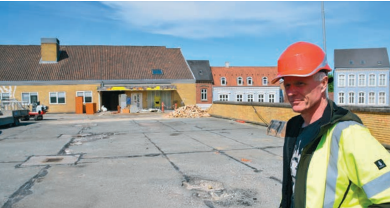
Der zuständige Ingenieur der Kommune, Henrik Møller, steht auf dem Parkdeck des früheren Supermarktes. Bei den Abrissarbeiten wurde dort Asbest entdeckt.
