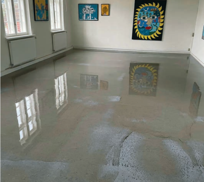
Der Ausstellungsraum des Kunsthauses nach der Sturmflut PRIVATFOTO
