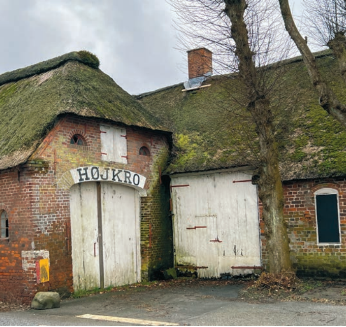
Der Verfall des Gebäudes ist für Passanten offensichtlich.
