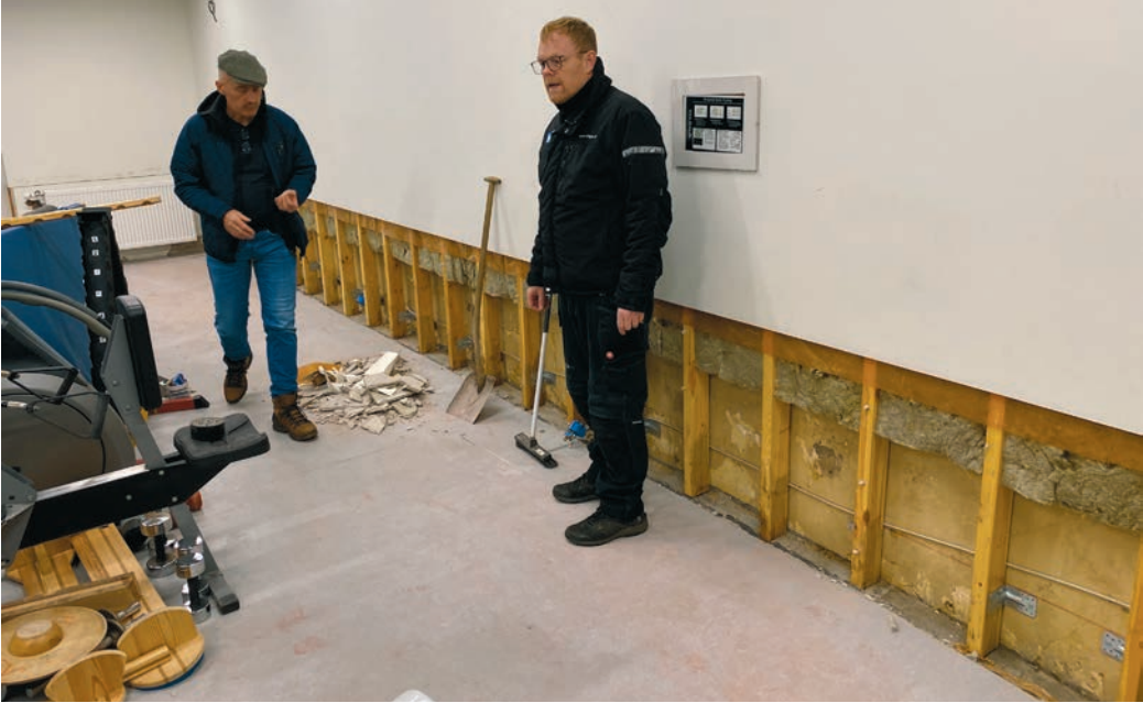
Der Boden, der erste halbe Meter der Gipswände und die Dämmwolle haben inzwischen freiwillige Vereinsmitgliedern entfernt.
