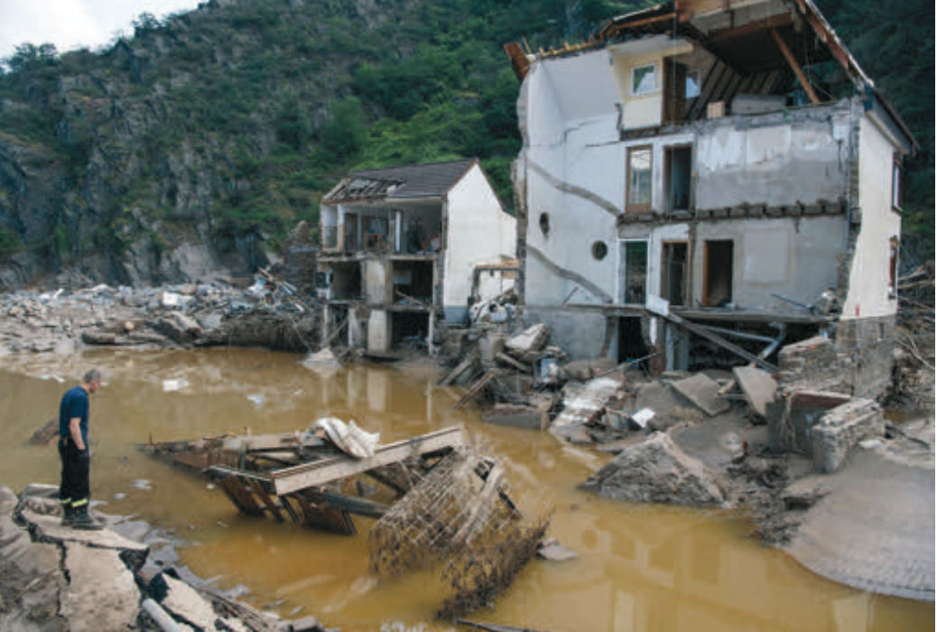
Ein Feuerwehrmann steht im Dorf Mayschoß vor einem völlig zerstörten Haus.
