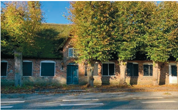
Die Fenster sind mittlerweile mit Holzplatten verrammelt worden. Früher standen sie sperrangelweit offen.
